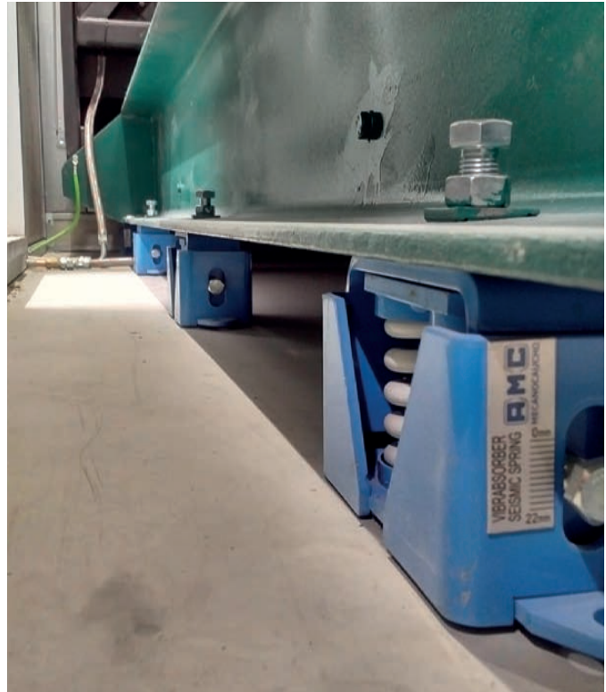
Compresor aislado con VIBRABSORBER+Sylomer®
